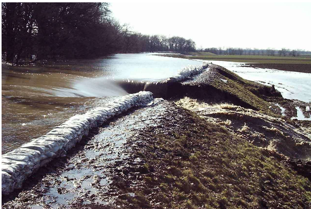
2. sz. kép A Tisza Tarpa-Tivadar közötti jobb oldali töltésszakadása (Forrás: VM Környezetügyi Államtitkárság)
